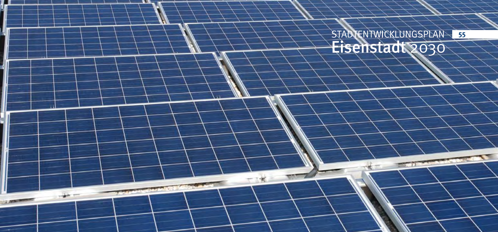
Erste Umsetzungen der Energieinitiative Eisenstadt: PV Anlage am neuen Bauhof
